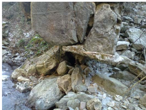
Fig 4: Particolare fondazione scalzata
