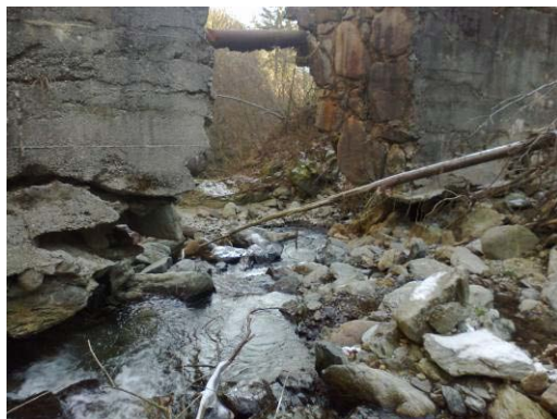
Fig 3: Vista da monte della fessura
