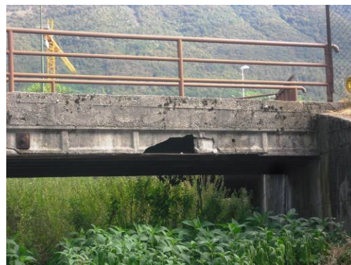
Fig.4: Particolare dell'impalcato e dei relativi problemi strutturali
