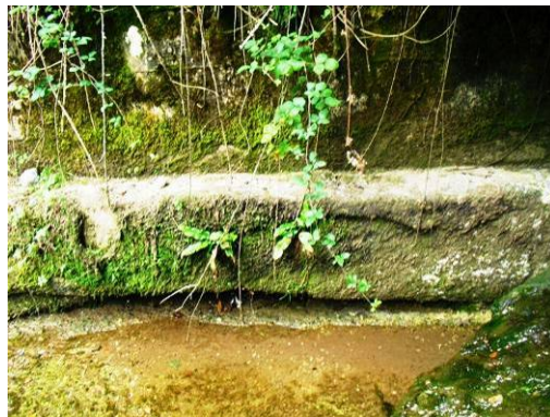
Fig.2: Particolare del piede sifonato da ripristinare del muro VRE001
