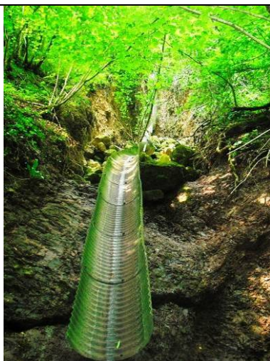
Fig.5: Vista del dissesto PA1012 da sistemare con interventi di ing. naturalistica
